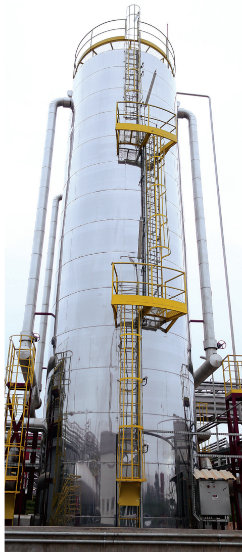
Figura 2 - Reservatório de Termoacumulação Estratificada - Volume 290 m 3
