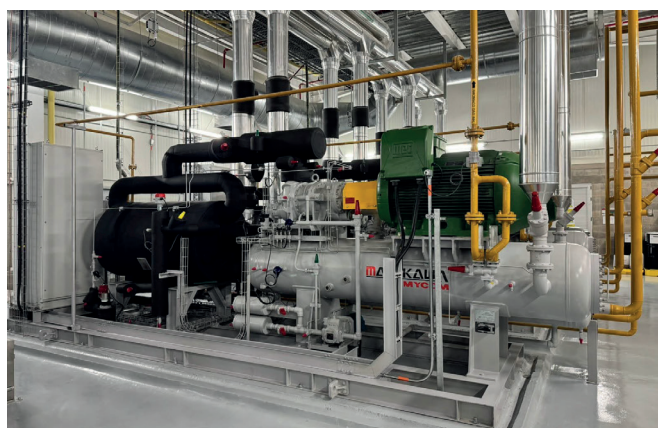
CHILLER instalado em Centro de Distribuição de Alimentos na Colômbia
